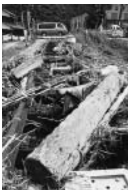
写真2 姫新線上月駅東踏切線路の盛り土を流され、流下物に覆われたJR姫新線は、被災後約2ヶ月間不通になった。2009年8月16日撮影。
