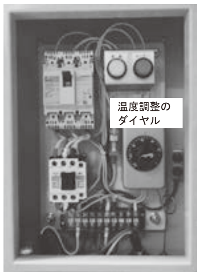
図10 気化器内部の漏電ブレーカーと温度調整のダイヤル（企画課作成）
