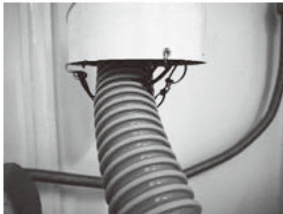
写真11 排気口と塩ビダクトの接続 (2021年10月7日 筆者撮影)
