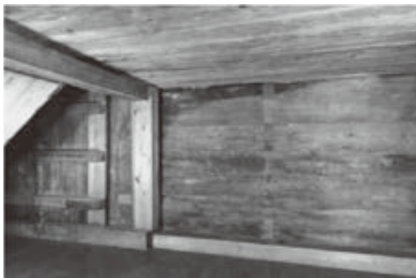
写真3 正倉院北倉壁に残る落雷痕（撮影：宮内庁正倉院事務所）
