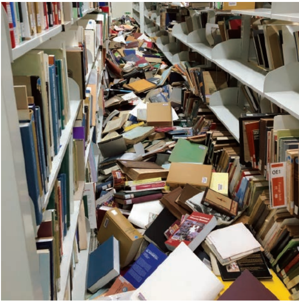
大阪府北部地震は展示場や図書館などに大きな影響をもたらした。写真は図書が落下した書庫のようす。
