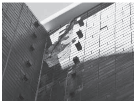
写真3 外壁タイルの一部落下 2018年6月19日 筆者撮影
