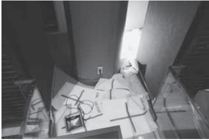
写真 9 スプリンクラーの破損による漏水箇所 2018年6月18日 国立民族学博物館 企画課撮影
