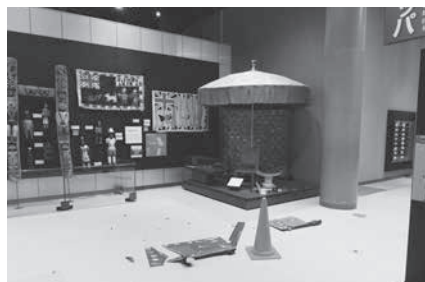
写真14 展示動線に落下していた防煙垂れ壁の破片 2018年6月18日 国立民族学博物館企画課撮影
