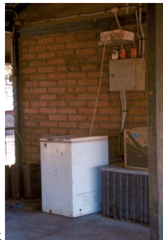
大型冷凍庫, ジベナ, 2004, 堀江
