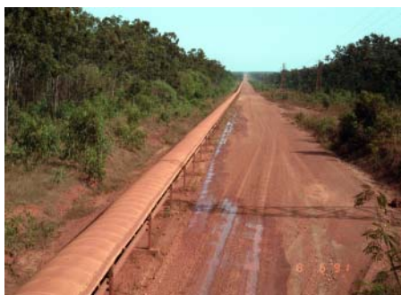
ボーキサイト搬送ベルトコンベヤー, 1991, 久保
