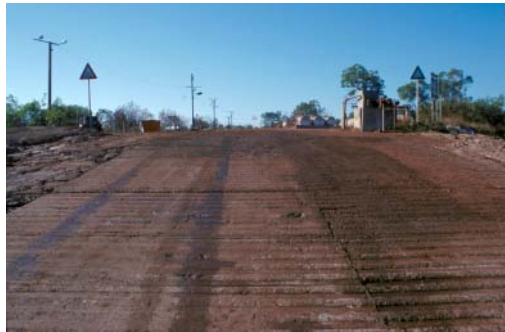
着岸用スロープ，マニングリダ，2004，堀江
