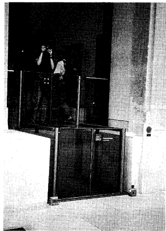
写真2 車椅子のための移動用リフトは、建物内のすべての段差に設けられている。
