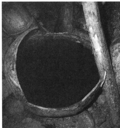
Foto 13 Pieza rota. Se puede apreciar la pared bien delgada.
