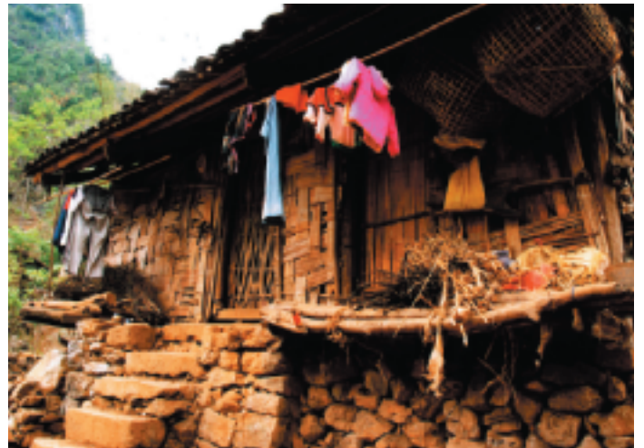
写真1 ヌン族の木造高床式住居。伝統的な、竹を編んで外壁としたもの。今では少なくなっている（チャリン県）。
